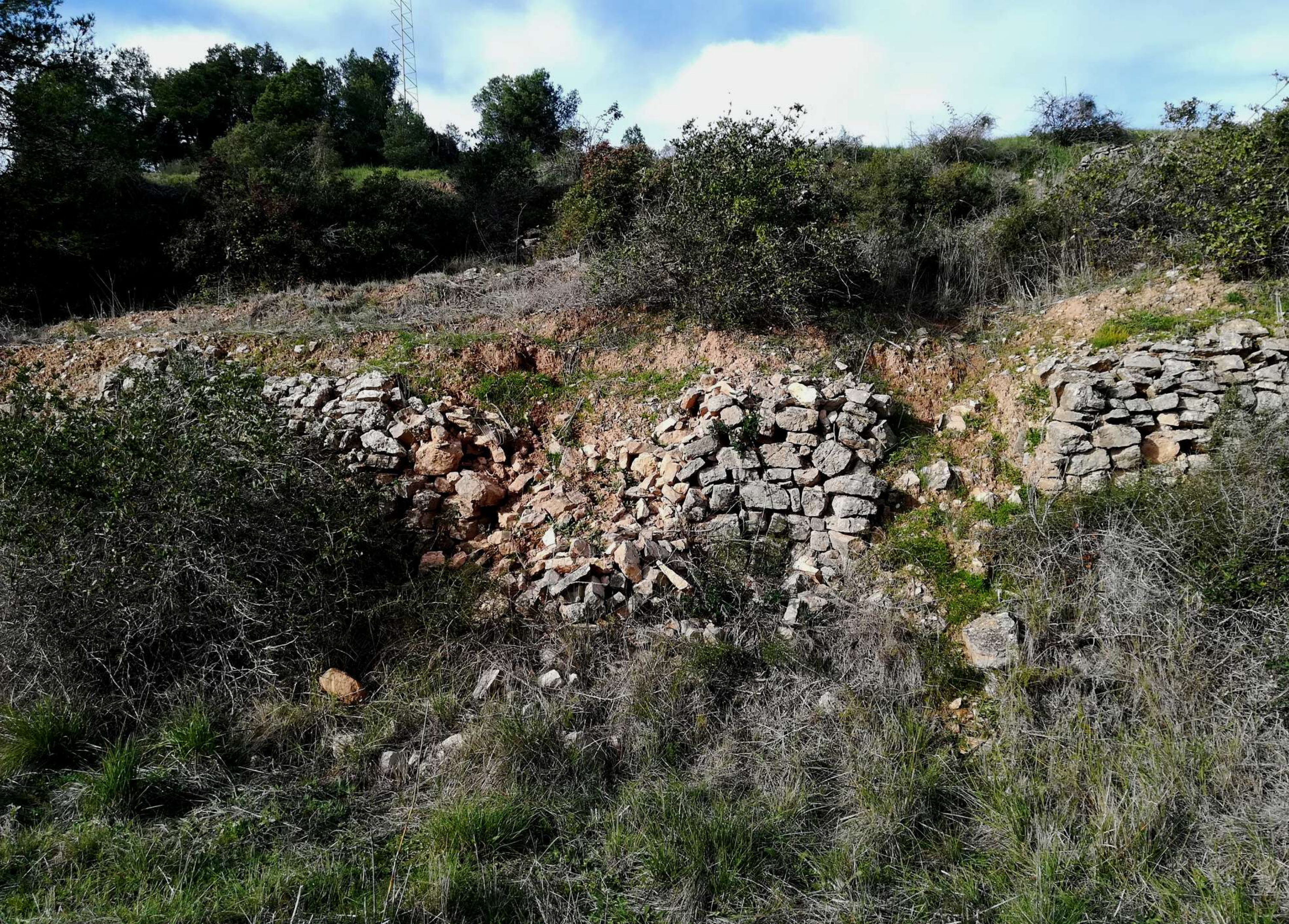
Portell (mur caigut) ubicat a la finca dels Canyerets del terme municipal de la Fatarella (Terra Alta).
